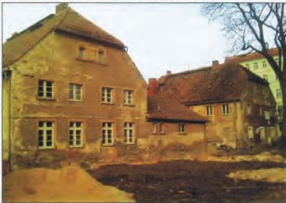
Mario Hoke will hier bald vermieten. Doch vor dem Ausbau musste die Nässe überall raus. Dank Matrolan hat er nun seine Immobilie auf Dauer völlig trocken.
