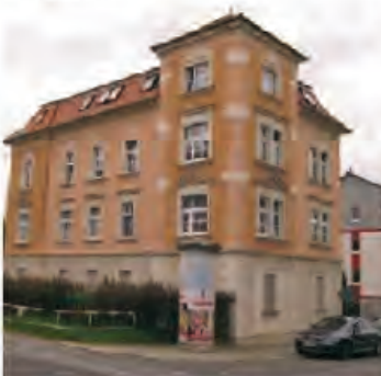
Weit über 10.000 Euro wurden in ein Injektionsverfahren investiert, um dieses Haus trocken zu bekommen. „Gebracht hat es fast nichts“, sagt der Eigentümer. Erst Matrolan löste sein Problem.
